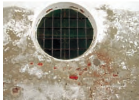
Voorbeeld van ernstige pleisterschade door de aanwezigheid van vocht en zouten
