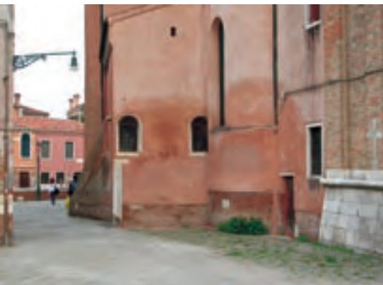
Gepleisterde kerkmuur met optrekkend vocht
