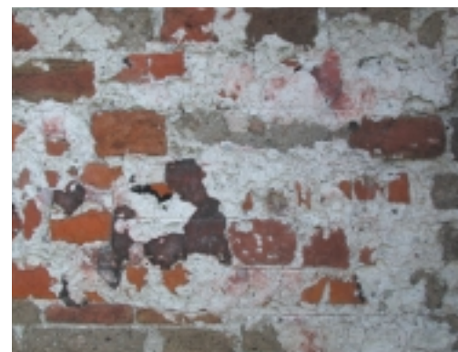
Een reparatie uit circa 1500 van 12de eeuwse metselwerk in tufsteen. Zichtbaar zijn de resten van een schelpkalkpleister over het baksteen reparatiewerk waarin dagstrepen van voegwerk zijn gesuggereerd. Ook zijn nog sporen van een roodbruine overschildering te zien. Friesland (foto RDMZ, A. Reinstra)
